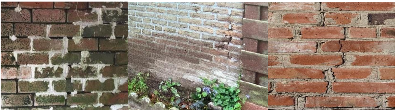
Schimmel, vocht en slecht metselwerk
