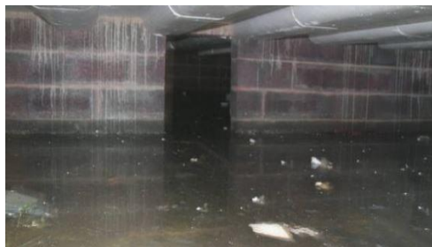
water in de kruipruimte
